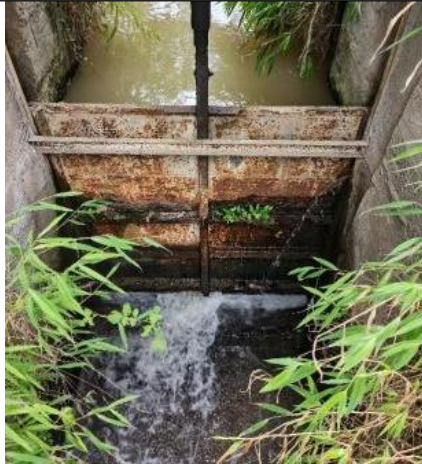
吴庙儿泄洪闸现状(闸室变形、闸房漏水、闸门锈蚀等问题)
