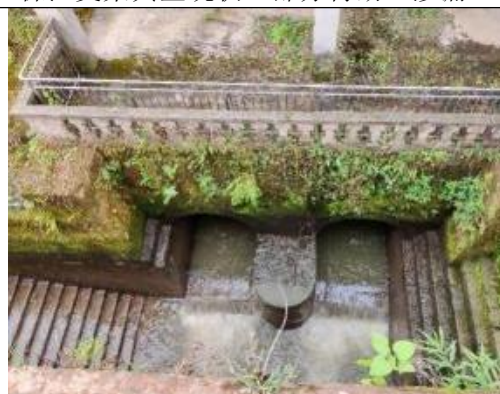
关子门堰进水闸现状（阀门老化、漏水）
