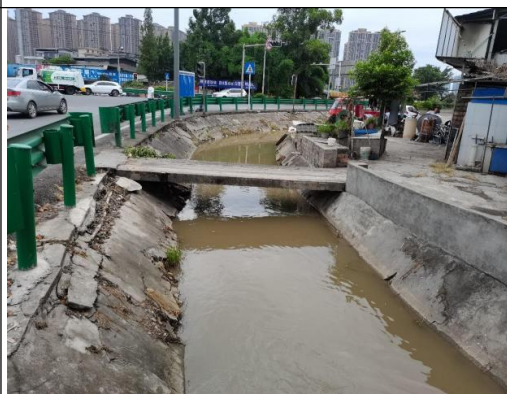
牟子支渠现状（已衬砌，渗漏）
