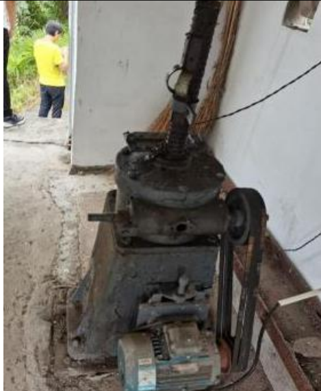
裸沱泄洪闸现状(闸室变形、闸房漏水、闸门锈蚀等问题)
