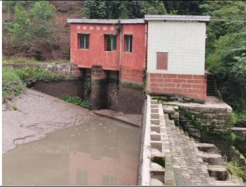
两河口节制闸现状(闸门锈蚀,启闭不灵,漏水严重等病害)
