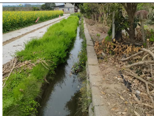
裸沱支渠典型现状（部分衬砌，渗漏）
