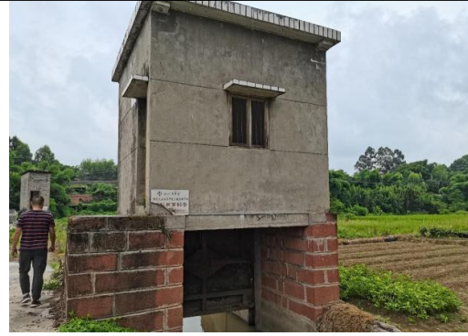
塘叫沟节制闸现状(闸室变形、闸房漏水、闸门锈蚀)
