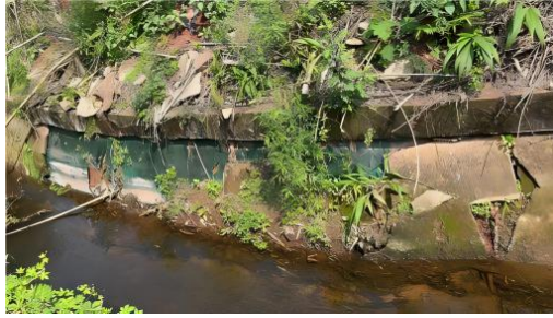
部分干渠边墙现状
