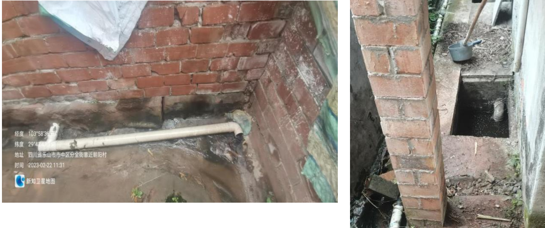
图 1-3 整治区排污现状
