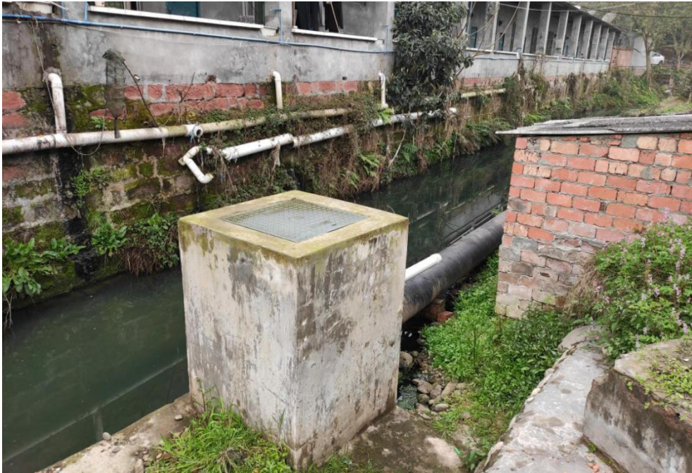
图 4.2-2 原石龙乡污水处理站尾水排口
